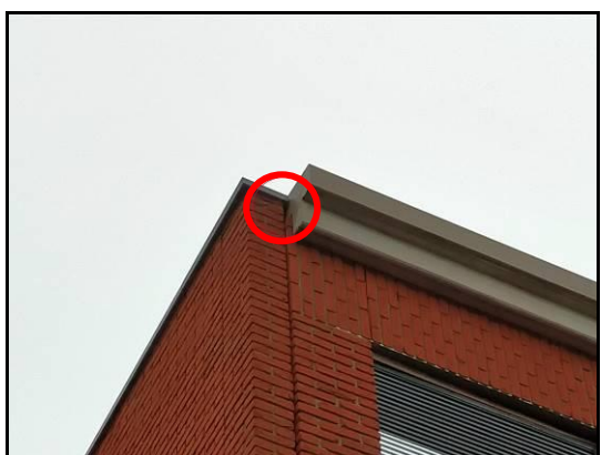
Afbeelding 6: Opening bij dakrand (3)
