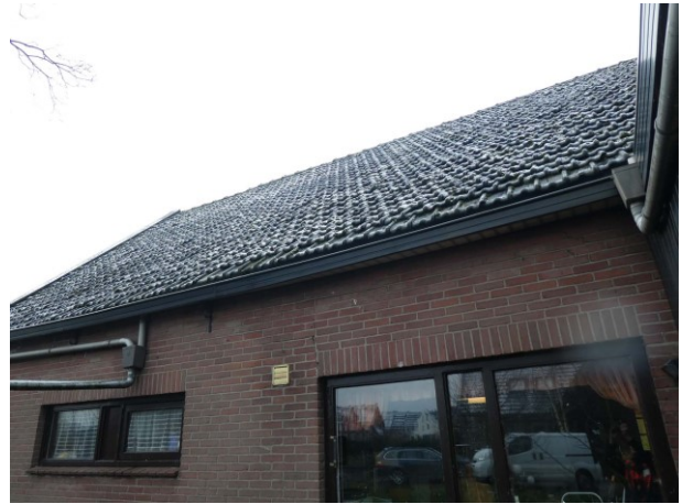
Figuur 31 Overzicht dak van de woning met verzakte dakgoot
