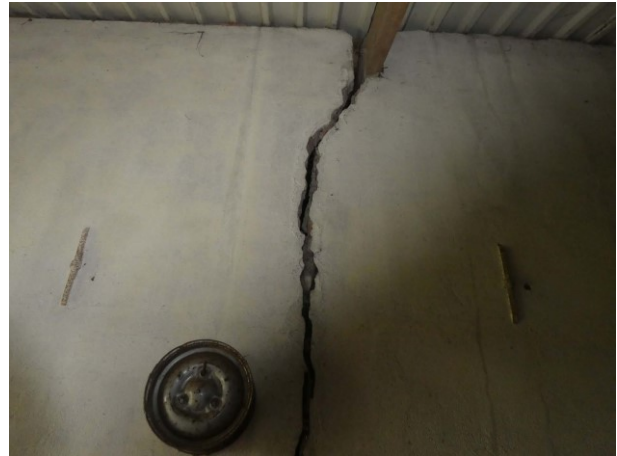
Figuur 26 Scheur in het stucwerk in de schuur
