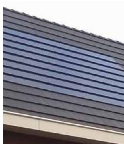
pv-panelen geïntegreerd in dakvlak
