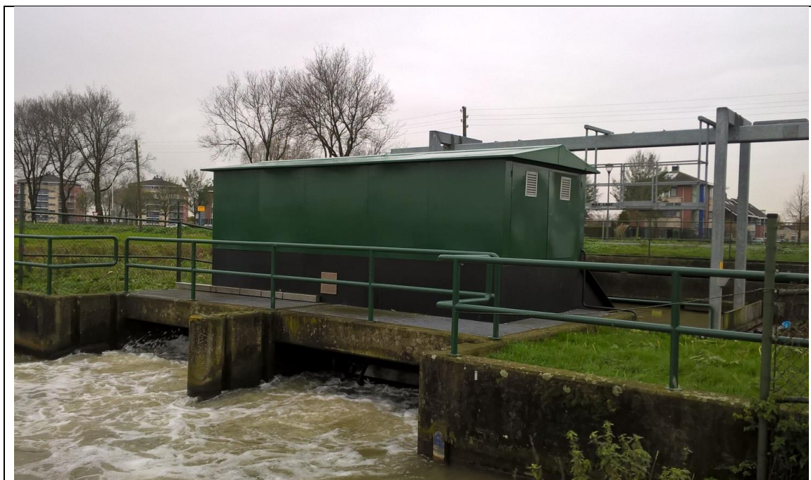
Figuur 2: Uitstroomzijde gemaal
