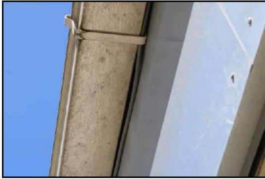
Afbeelding 5: Openingen achter dakgoot
