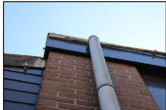
Afbeelding 8: Openingen onder dakrand
