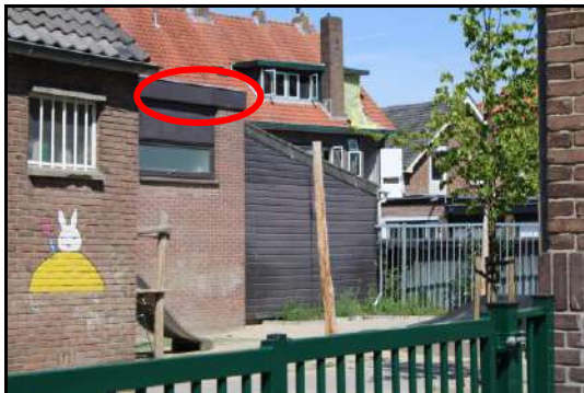
Afbeelding 7: Openingen onder dakrand
