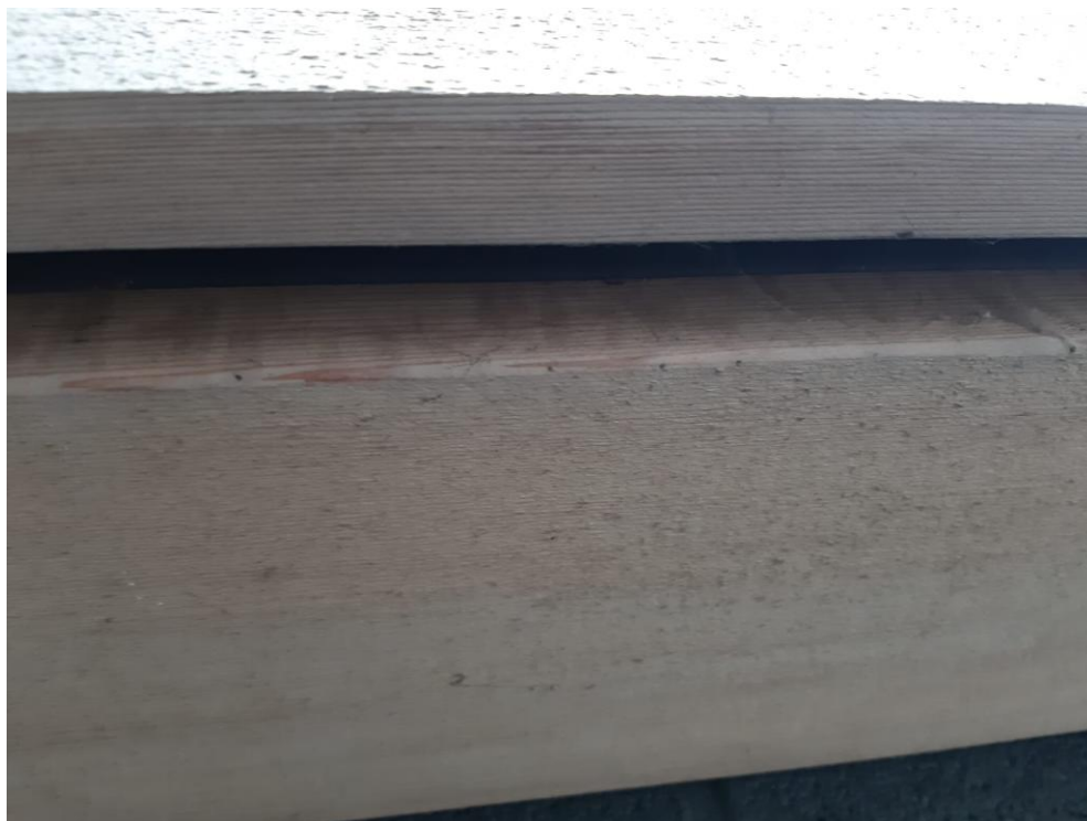
Figuur 9 Open ruimte tussen houten beplating kantoorgebouw.
