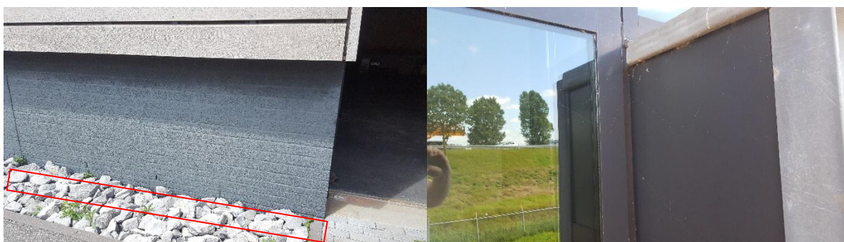
Figuur 8 Foto links: bakstenenmuur met open stootvoegen. Foto rechts: aansluiting trespaplaat op raamkozijn.
