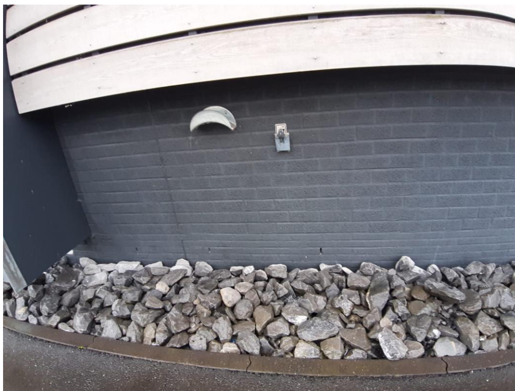
Figuur 8 Open stootvoegen in het kantoorgebouw.
