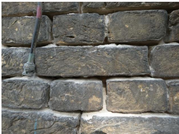
Figuur 23 Muur met deels verdwenen voegsel
