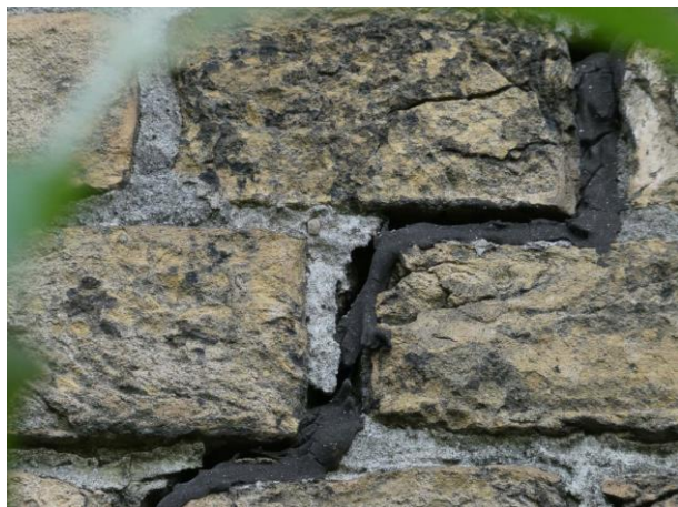
Figuur 24 Dicht gekitte scheur in de muur
