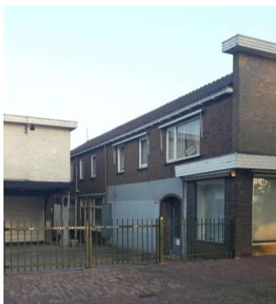
Figuur 3. Een van de panden gezien vanaf de straat Nesse waar de goot aanwezig is en een klein gedeelte met dakpannen. Te zien is dat het naastgelegen pand op korte afstand is gelegen.
