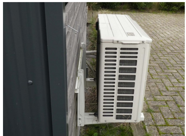
Figuur 20 Airco-unit op de zuidelijke muur
