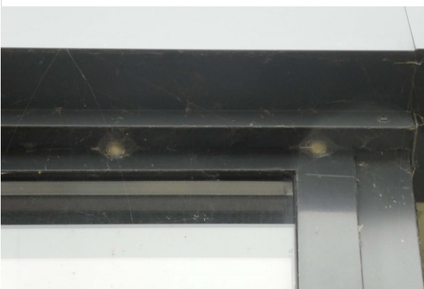
Figuur 25 Spinnennesten op kozijn aan de zuidzijde van het gebouw
