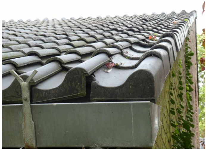
Figuur 12: Afgesloten dakpannen
