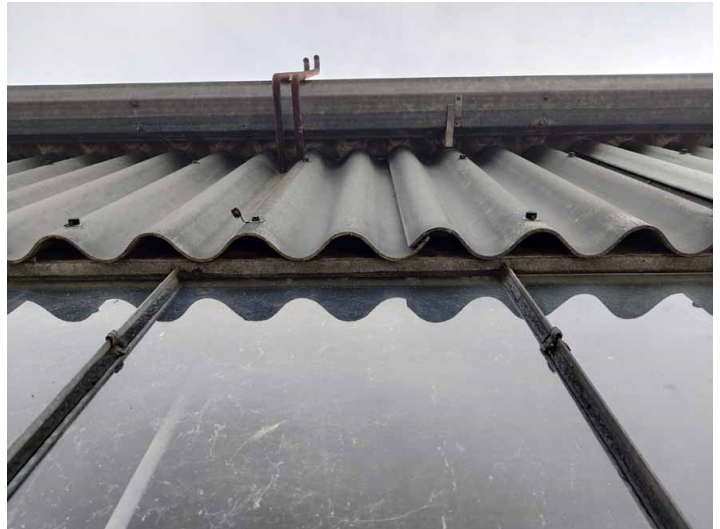
Figuur 14 Zwarte golfplaten aan oostzijde van de bedrijfsloods
