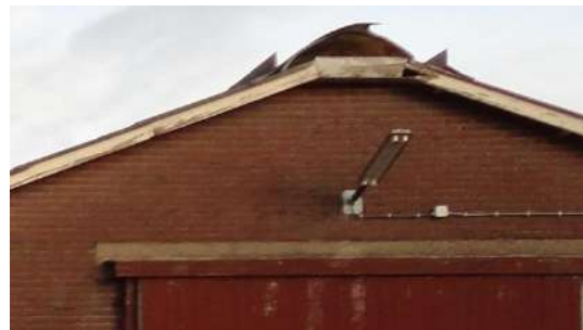
Foto 24 kapotte nokconstructie dubbele schuur
