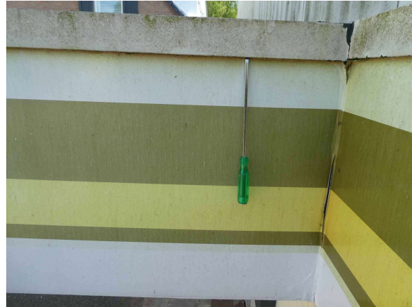
Figuur 18 Geen ruimte tussen Trespa platen
