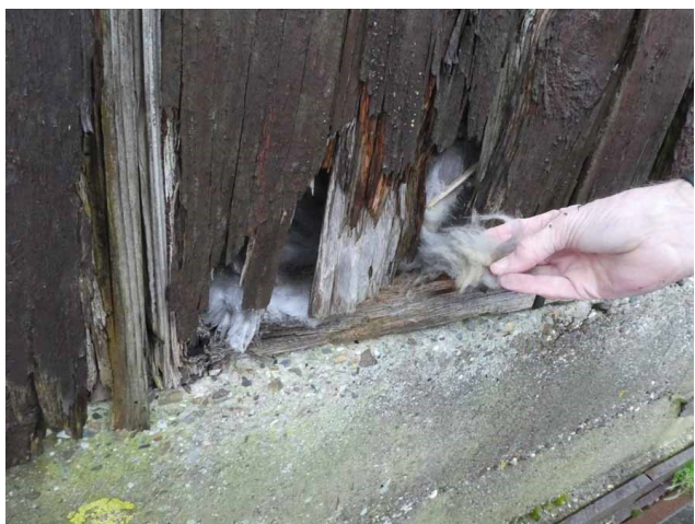
Figuur 24 Scheur met glaswol isolatiemateriaal
