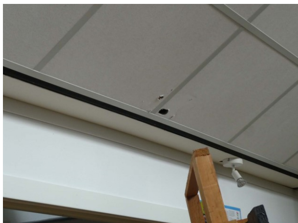
Figuur 14: Gat in systeemplafond.
