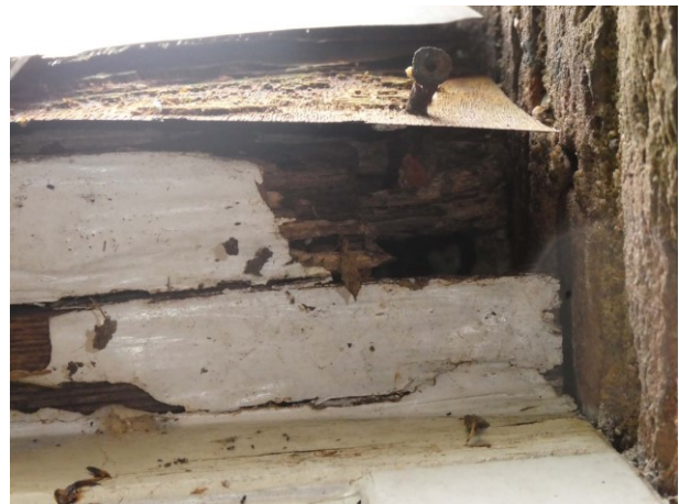
Figuur 25: Rot plek onder trespabeplating aan de noordkant.
