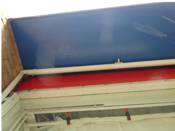
Figuur 21: Opening tussen trespa platen aan de westkant.
