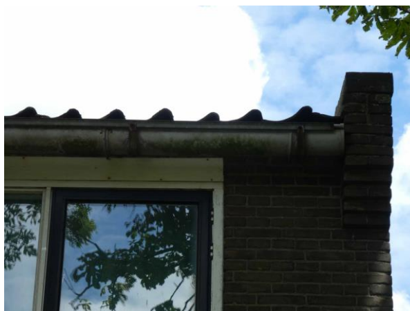
Figuur 28 Detail dakgoot met hoog liggende, uitstekende dakpannen, gevoelig voor wind en tocht
