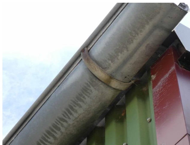
Figuur 13 Ruimte tussen dakgoot en schuurwand
