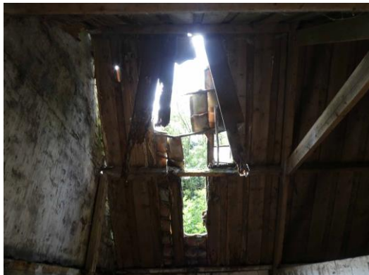
Figuur 24 Gaten in dak schuur 5
