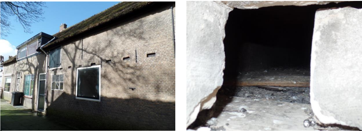
Figuur 10: Links: oostelijke gevel woonhuis met ventilatieopeningen. Rechts: veren en mestsporen van een duif in een van de ventilatieopeningen.
