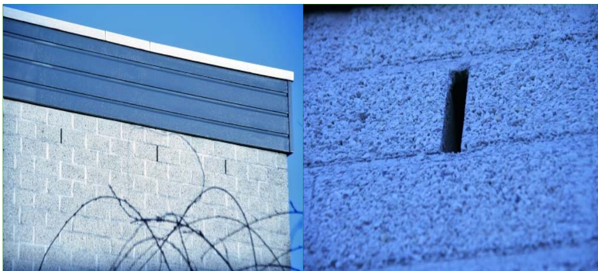
Aangetroffen gaten in de muur van het woonhuis geven mogelijk toegang tot voor vleermuizen geschikte holtes.
