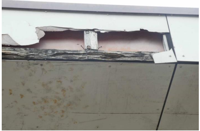
Figuur 12: Constructie onder tresaplaten. Deze locatie is door schade aan de platen te open en tochtig en ligt ook op het zuidwesten gericht.
