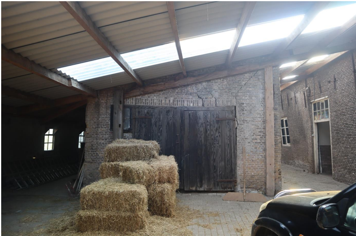
De bestaande achtergevel van het zomerhuisje verkeert in erg slechte staat en toont ernstige vormen van instabiliteit. Ook deze gevel is aan het zicht onttrokken door de uit 1965 stammende aanbouw.
