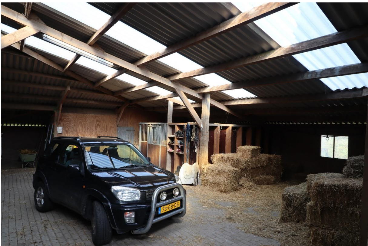
De uit 1965 stammende uitbouw herbergt geen cultuurhistorische waarde en doet afbreuk aan de verschijningsvorm van het complex.
