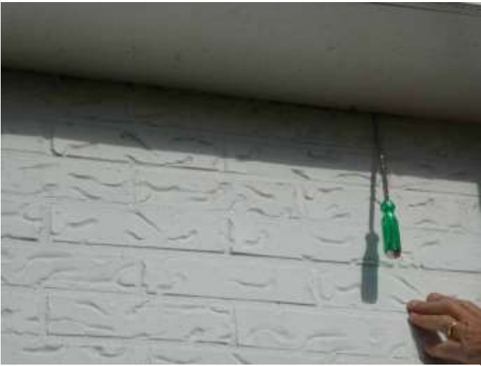
Figuur 24 Geen ruimte houten boeidelen/muur
