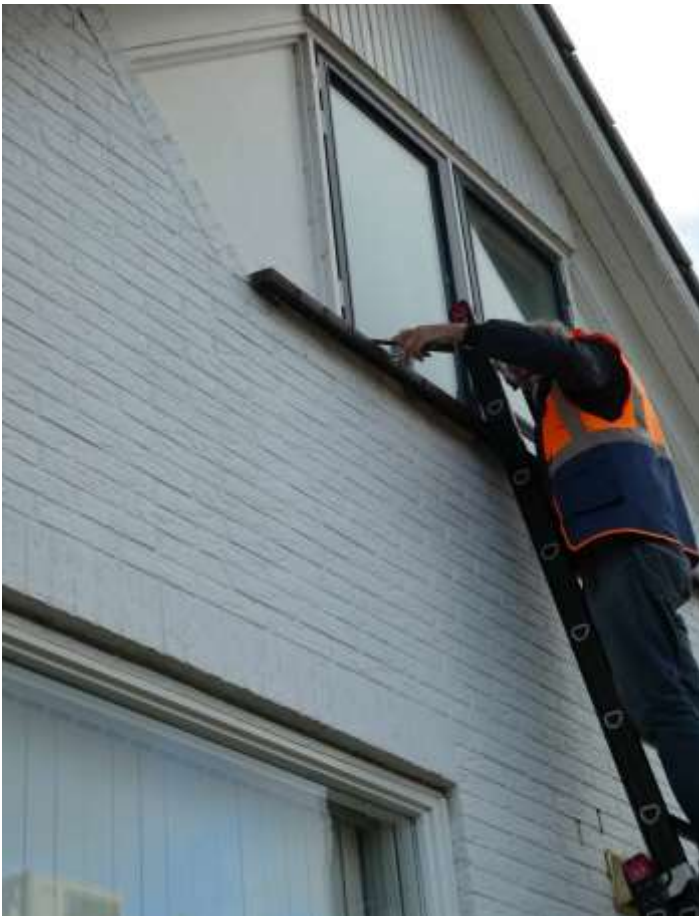
Figuur 25 Inspectie sporen raamdorpels
