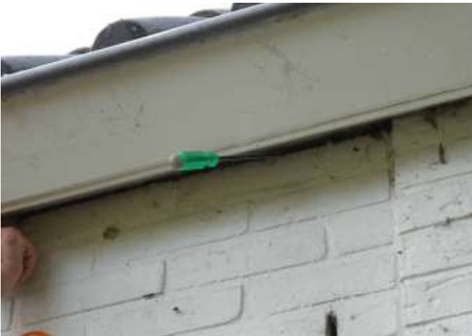
Figuur 20 Geen ruimte dakgoot/muur
