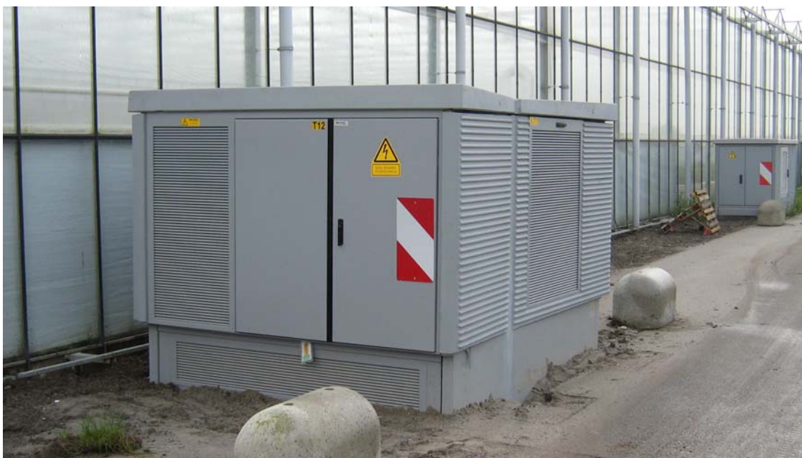
Afbeelding 5-1 Transformatorstation t.b.v. assimilatiebelichting
