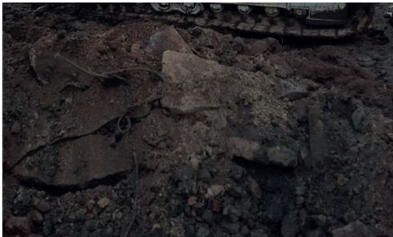
Figuur 5: Bodemvervuiling van beton, kabels en sloopafval.
