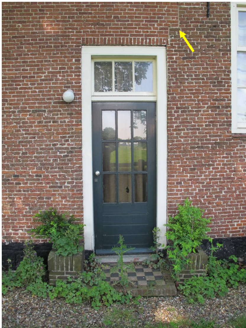
De voordeur, met in de rechter dagkant duidelijk verstoord metselwerk. De rollaag steekt door buiten de opening. Hierboven een duidelijke bouwnaad (pijl).
