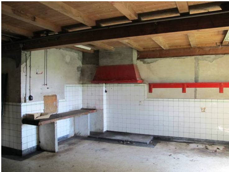
Werkbank en schouw tegen voorwand spoelruimte.
