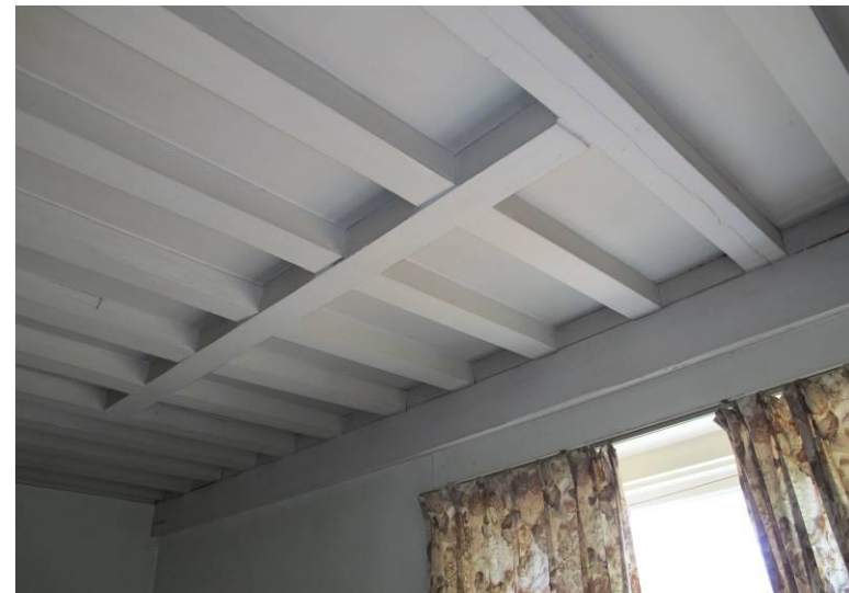
Dichtgezette raveling naast de noordgevel van de voorste opkamer.
