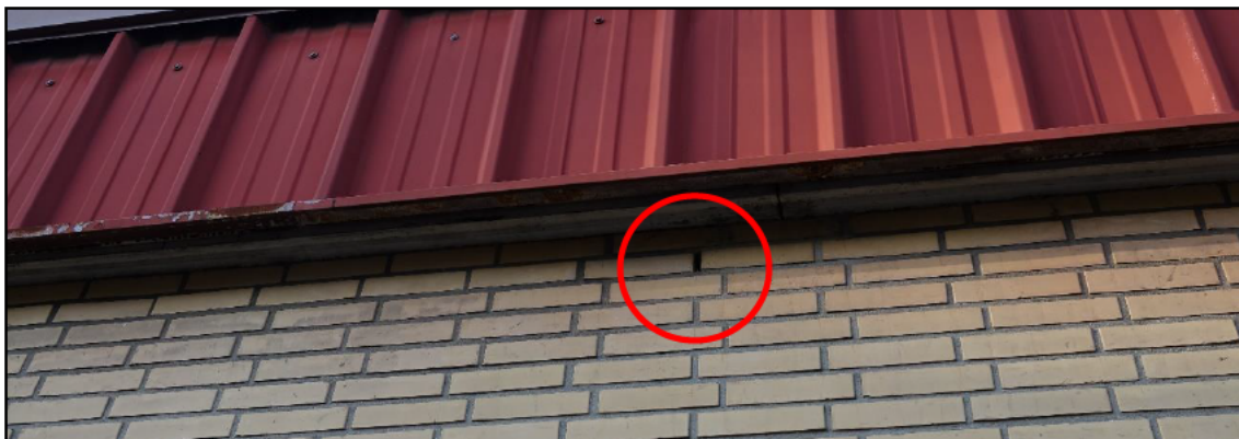
Figuur 8: Open stootvoegen kunnen dwergvleermuizen toegang verblijfplaatsen in de spouwmuur verschaffen.
