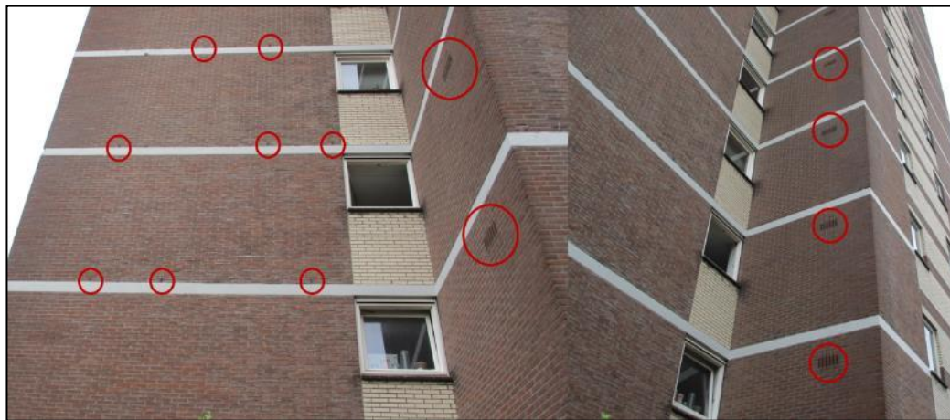
Figuur 1.3 In de flats zijn stootvoegen en ventilatieopeningen aanwezig, welke mogelijk kunnen leiden tot een luchtpouw. Hier kunnen vaste rust- en/of verblijfplaats van vleermuizen aanwezig zijn. De potentie in de bebouwing bestond met name uit de kopgevels.
