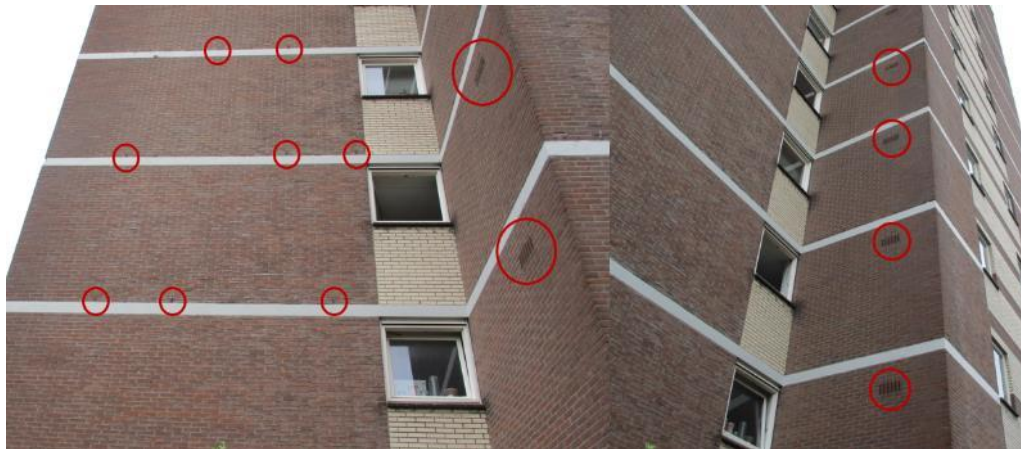
Figuur 2 In de flats zijn stootvoegen en ventilatie-roosters aanwezig, welke mogelijk kunnen leiden tot een luchtsponw. Hier kunnen vaste rust- en/of verblijfplaats van vleermuizen aanwezig zijn.
