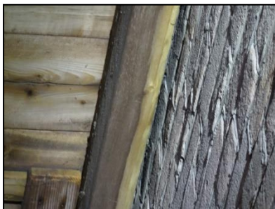
Figuur 9. Ruimte tussen het metselwerk en de houten balk van het plafond in de steeg.
