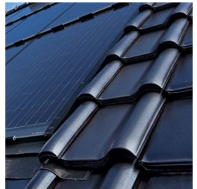
Zonnepanelen op schuin dak
