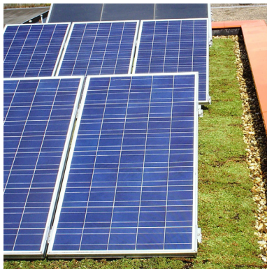
Groen dak gecombineerd met zonnepanelen
