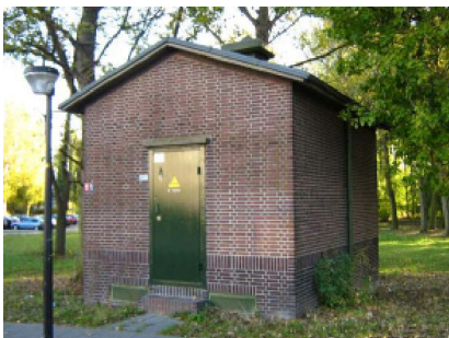
trafohuisje Van Hogendorpstraat
