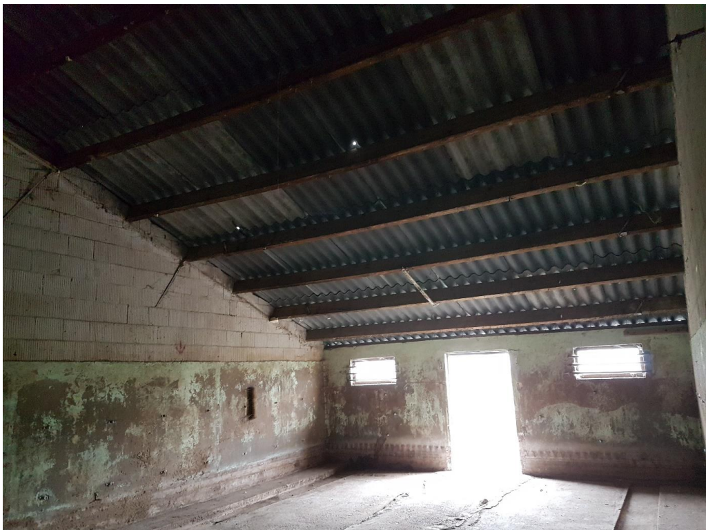
Figuur 4 De te saneren stal is aan de binnenzijde geheel kaal. Er zijn geen platen bevestigd aan het dak, dakbeschot ontbreekt en overige afwerkingen zijn niet aanwezig.
