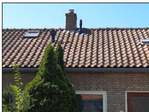
Foto 3: kieren tussen daklood rondom de schoorstenen kunnen toegang bieden tot het dak.
