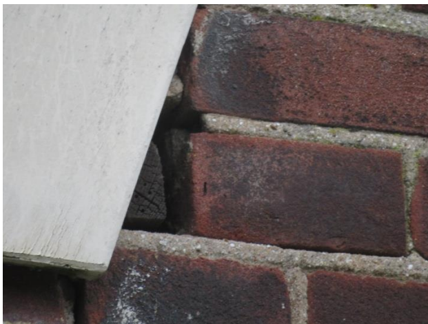
Afbeelding 6: kier die niet doorloopt bij draagbalk
