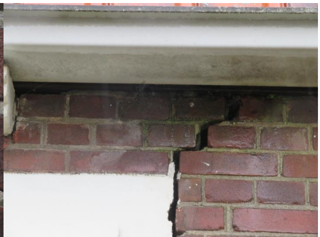
Afbeelding 7: kier in muur waar water inslaat en zonder achterliggende ruimte
