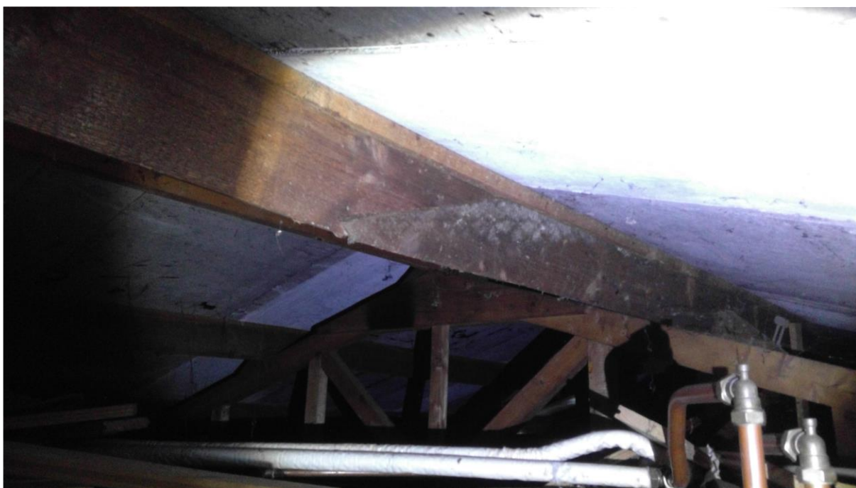
Foto F22 Plaatmateriaal type 1 Zolder
