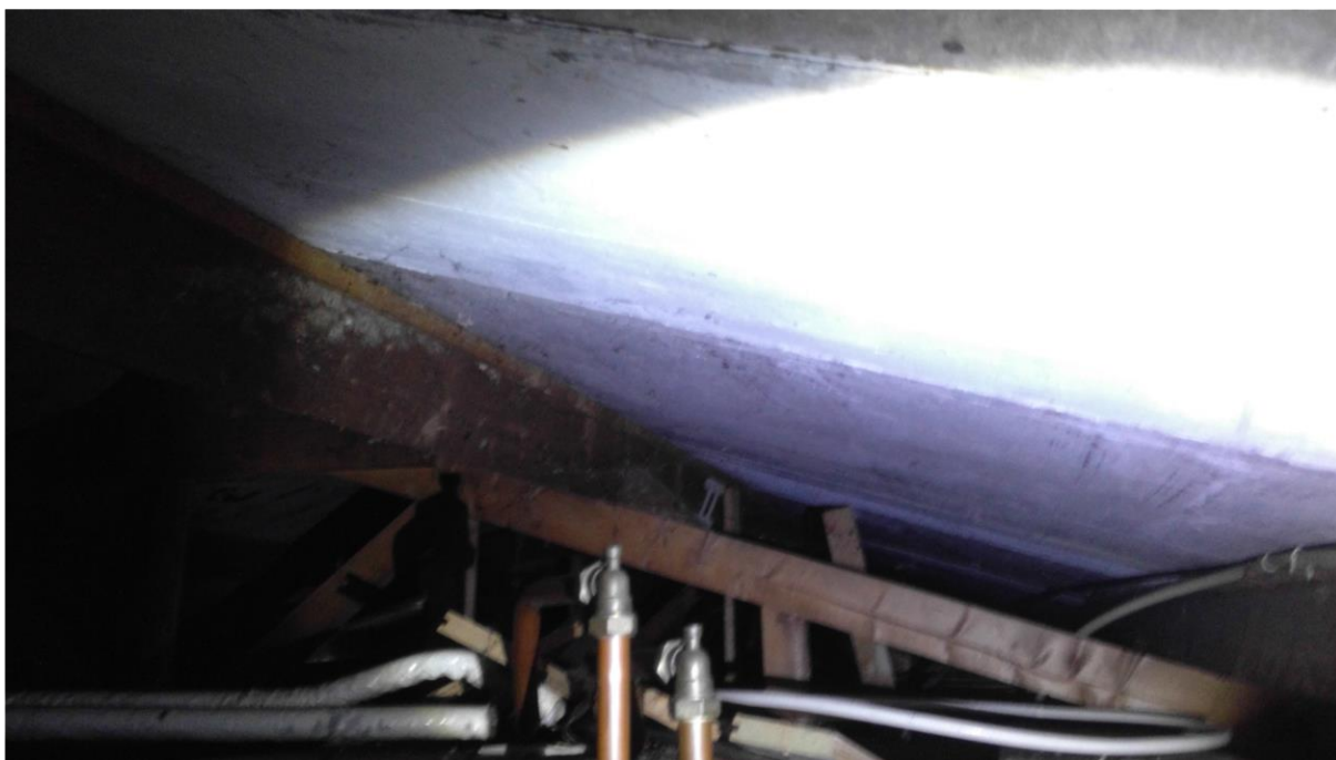
Foto F23 Plaatmateriaal type 1 Zolder
