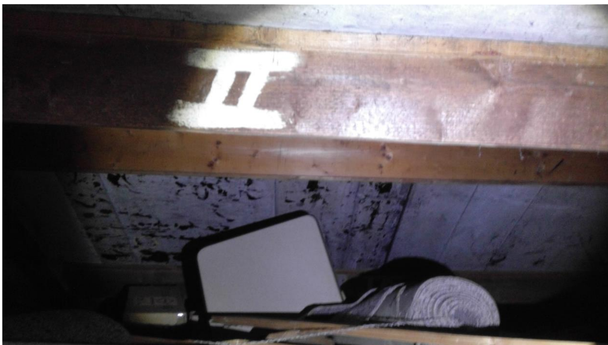
Foto F21 Plaatmateriaal type 1 Zolder
