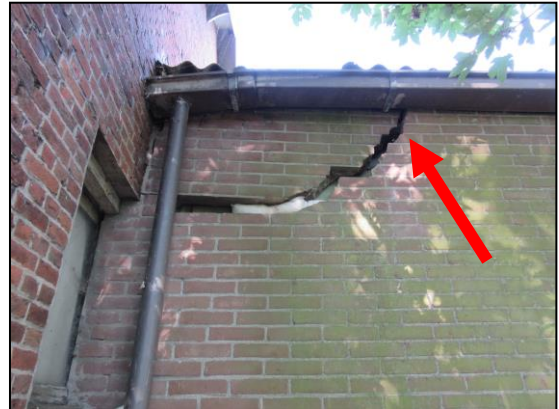
Foto 6: Scheur in muur
