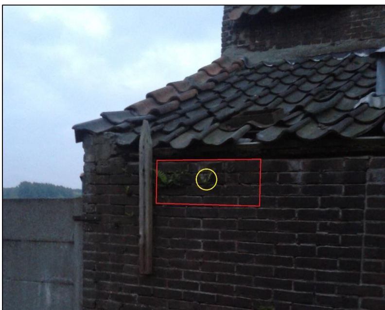
Figuur 1. Locatie van de tongvaren in de muur van het pand (gele cirkel) en het stuk uit te zagen muur (rood omlijnd).
