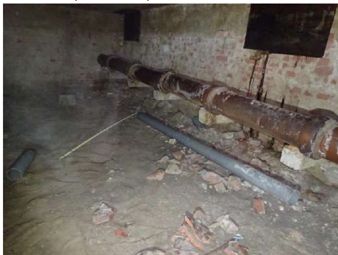
Kruipruimte met pvc, gres en gietijzer riolering
