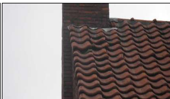
Foto 3: Ruimtes tussen dakpannen
