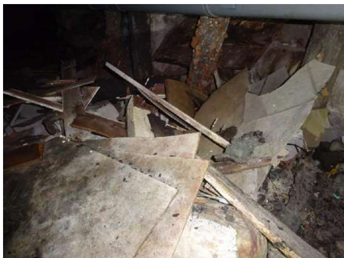
Vinylzeil in de kruipruimte niet asbestverdacht
