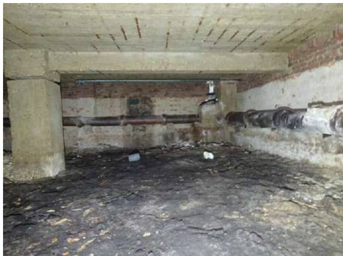
Kruipruimte met pvc, gres en gietijzer riolering
