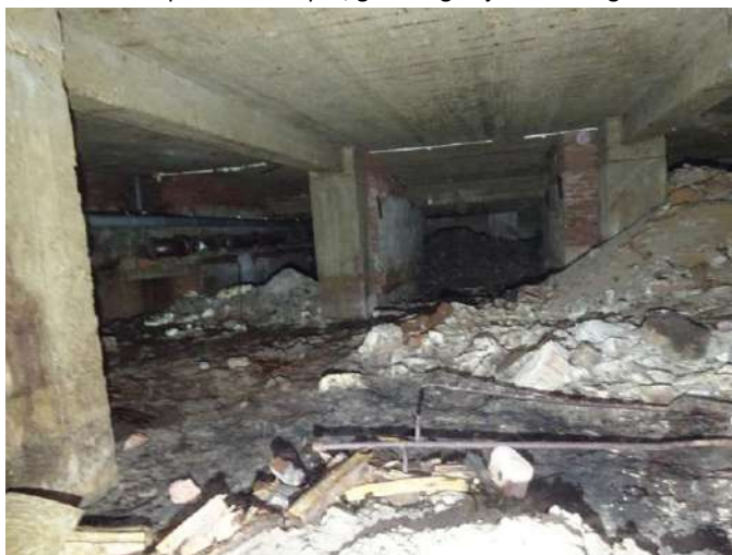
Kruipruimte met pvc, gres en gietijzer riolering
