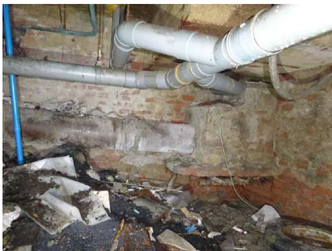
Kruipruimte met pvc, gres en gietijzer riolering
