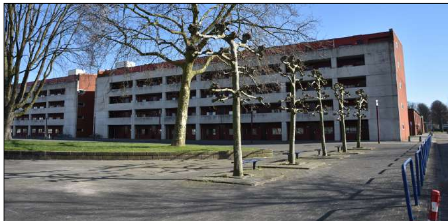
Figuur: rondom het plangebied zijn diverse appartementencomplexen en woningen aanwezig. Er zijn open stootvoegen aanwezig waar vleermuizen in kunnen kruipen. Via deze openingen kunnen ze de spouw bereiken waar ze verblijfplaatsen kunnen hebben.
