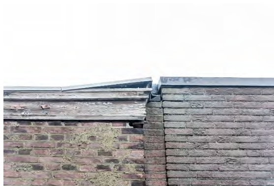
Openstaande daktrimmen en gevelbetimmering
