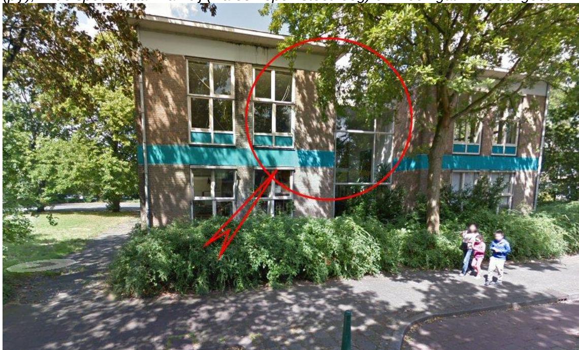
Foto 9, paarplaats in de zijgevel van het schoolgebouw, in de kast van de zonwering (pijl), in de spouw daar vlak bij (via een open stootvoeg) of in een gat in de dakgoot
