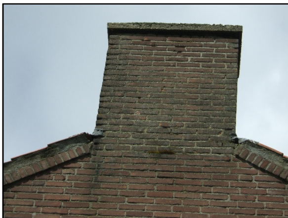
Foto 3: Schoorsteen met potentiële invliegopeningen
