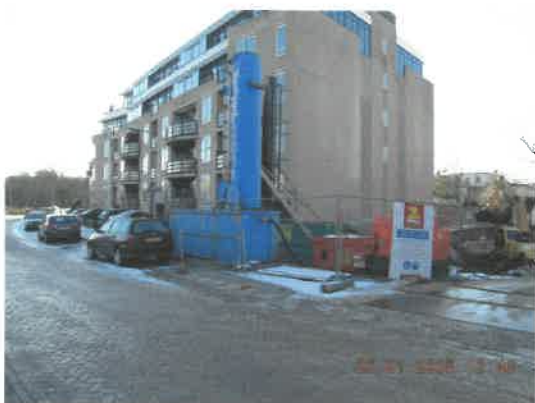
Foto 3: Opstelling dubbele waterzuivering
