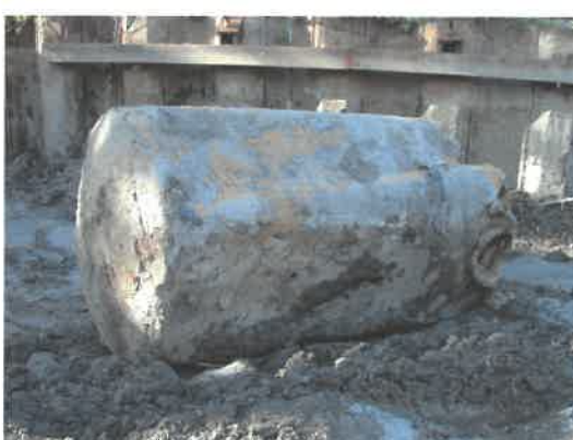
Foto 6: Halve ondergrondse tank
