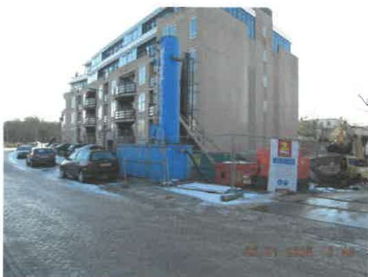
Foto 3: Opstelling dubbele waterzuivering
