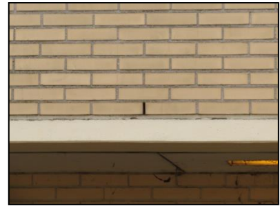
Figuur 5. Open stootvoeg mogelijke ingang voor vleermuizen.
