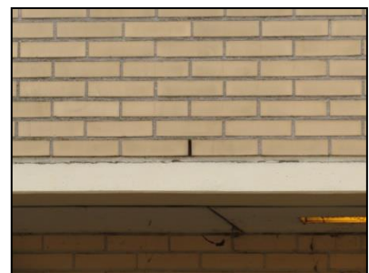
Figuur 5. Open stootvoeg mogelijke ingang voor vleermuizen.
