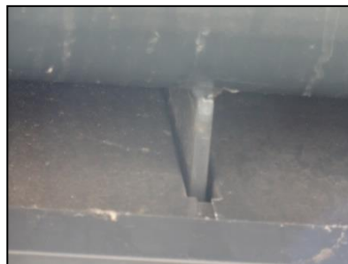
Figuur 10. Opening in en ruimte achter gevelbekleding aan oostzijde van de bebouwing.
