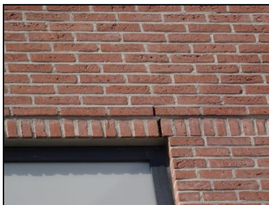
Figuur 9. Open stootvoegen in de gevel.
