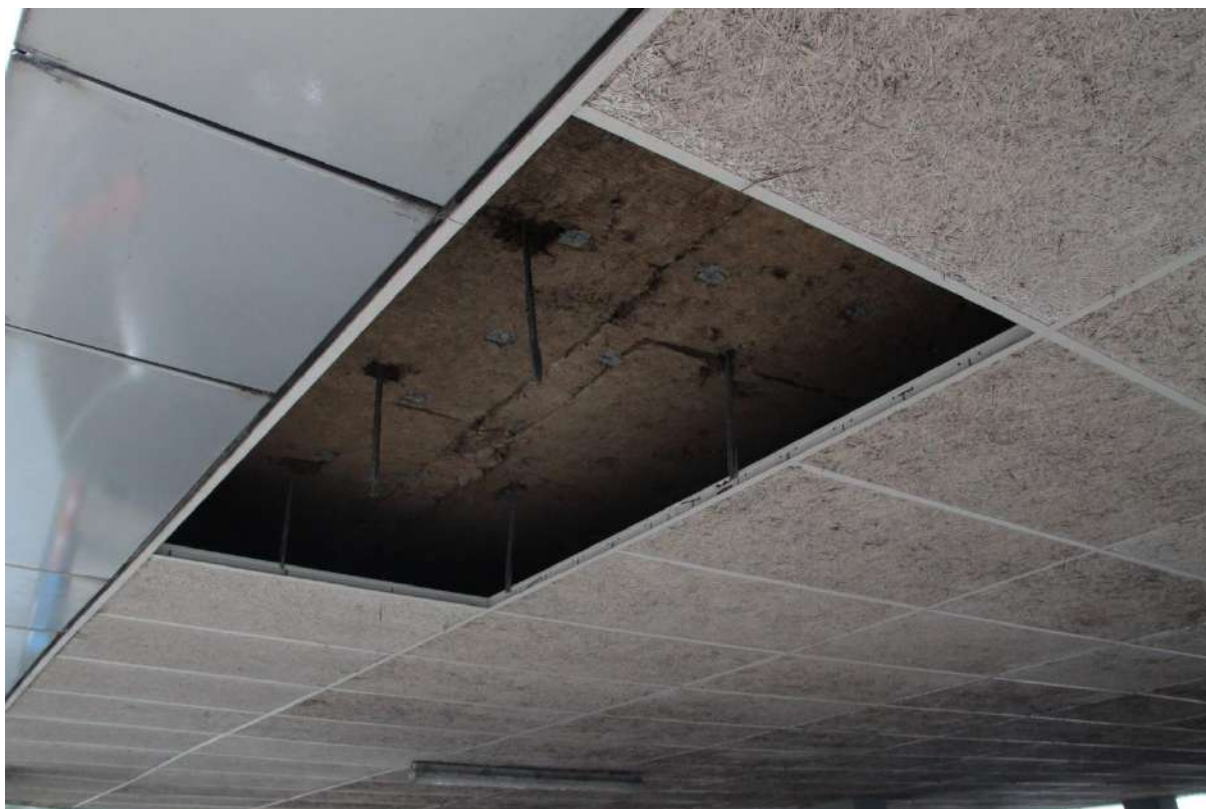
Figuur 11: Isolatiemateriaal van dichterbij gezien.
