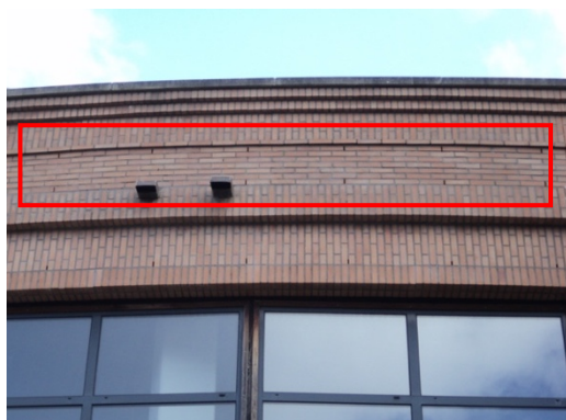
Open stootvoegen langs de oostelijke gevel ter hoogte van het voormalige V&D-gebouw.
