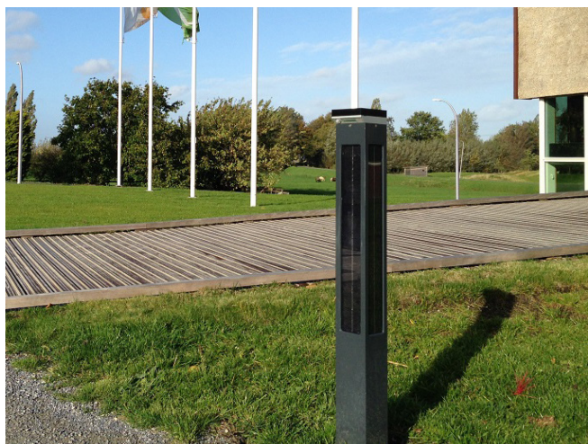
Buitenverlichting met detectie, werkend op zonne-energie (Sysconnect bij gemeentehuis Midden-Delfland)
