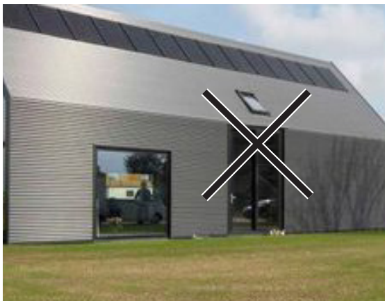
FOUT: Kozijn niet laten eindigen op goothoogte GOED: materiaal dak loopt in gevel door
